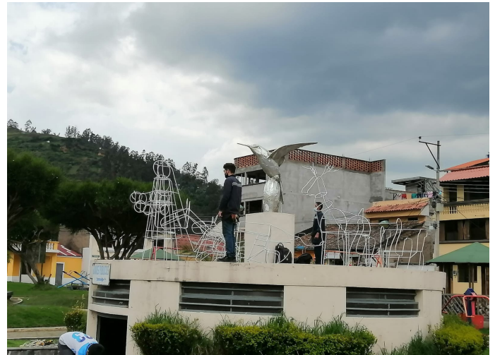
Figura Nro. 42: Instalación de pesebre ornamental - Guangopolo Fuente: Comisión de Vinculación Mecánica Industrial
