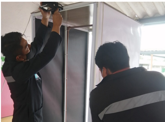
Figura Nro.35: Instalación de cabinas de desinfección en la escuela Santiago Apostol - Puenbo
